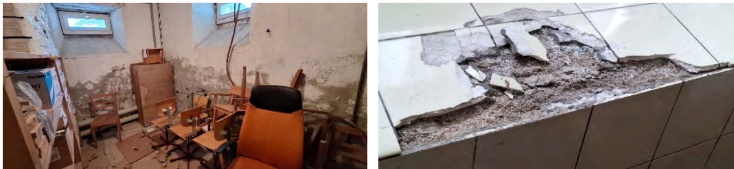
Abbildung 3: Schimmel und Abplatzungen im alten Schulhaus
