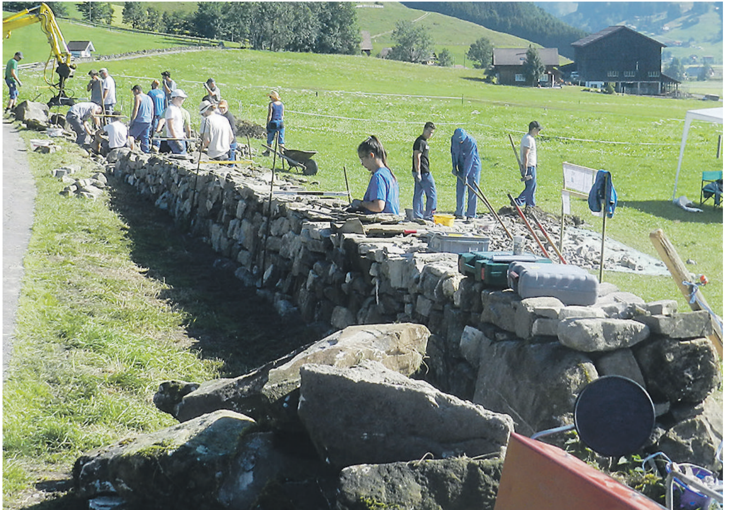
An der alten Gasse wurde eine 38 Meter lange Trockensteinmauer abgebrochen und neu aufgebaut.
