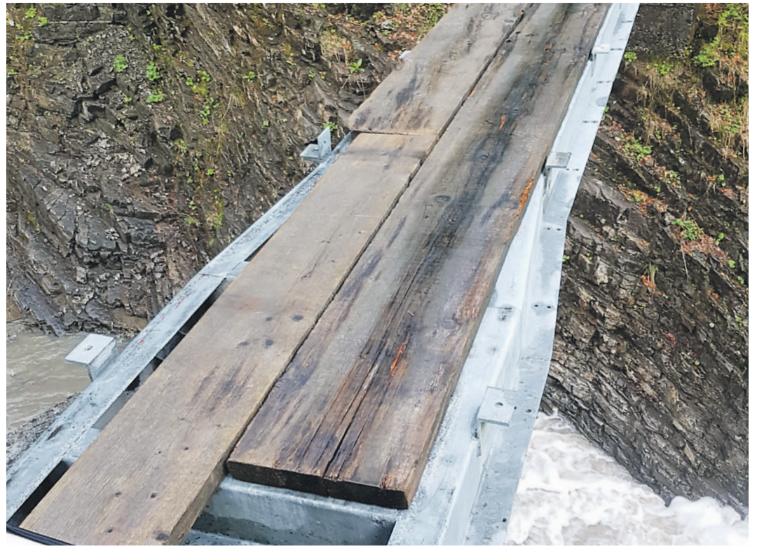
Die Brücke Gribtschli, wie sie sich vorher präsentierte.
